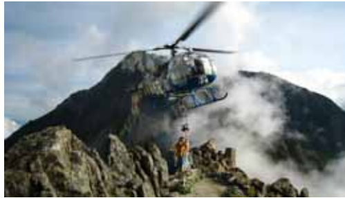
【工事の様子を紹介します。】（H19 槍ヶ岳、南岳の工事から） 資材はヘリコプターで運搬
