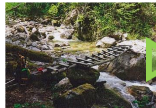
老朽化した木橋
